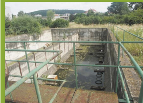
Nejenže se hluboké nádrže bývalé čistírky pomalu měnily na černou skládku, ale především byly velmi nebezpečné
